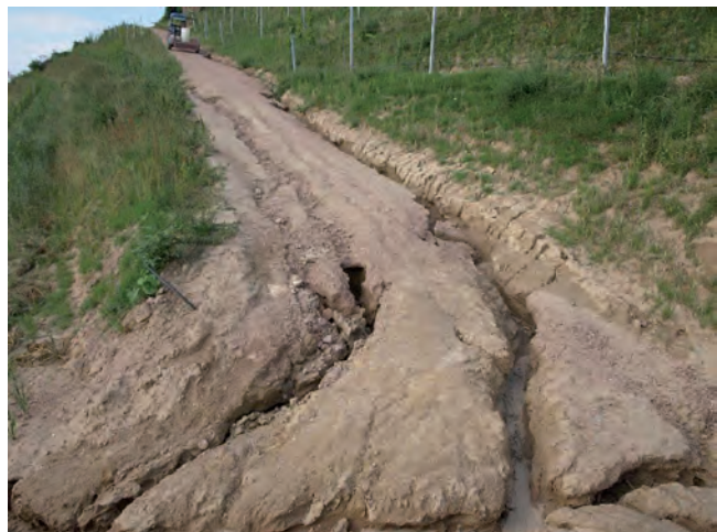
Abb. K.8: Beispiel einer Rinnenerosion in Weinbergschlucht nach Starkregen. (Foto: © LUBW; Autor: C. Ritter)
